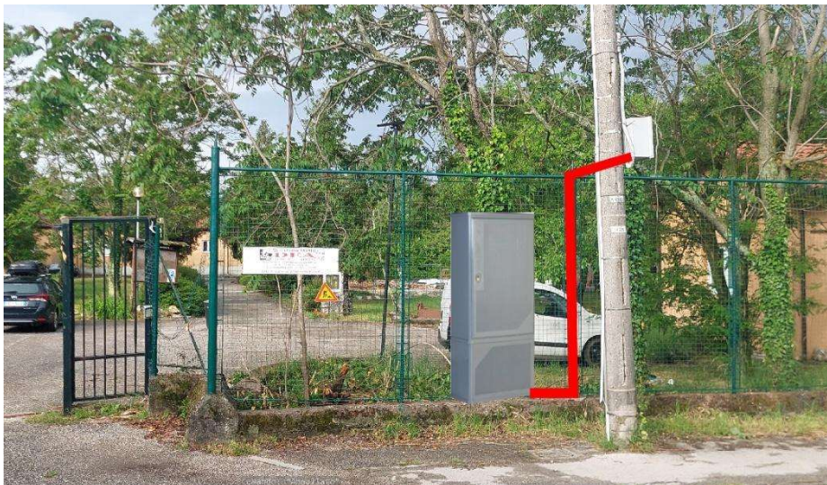
Figura 6 Foto inserimento armadio stradale
